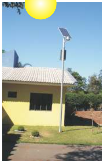
Kit solar instalado na sede administrativa da AERO: composto de bateria, placa captadora de luz solar, fotocélula e luminária. A luz é utilizada para iluminar o pátio durante a noite.
